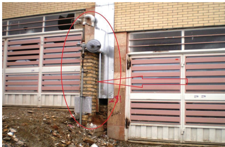
تصویر ۳- ناهماهنگی در اجرا- سایت حاج شمسعلی
